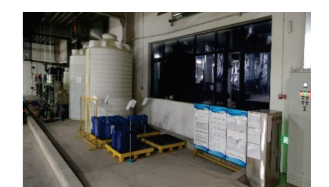
循环水处理现场设备
