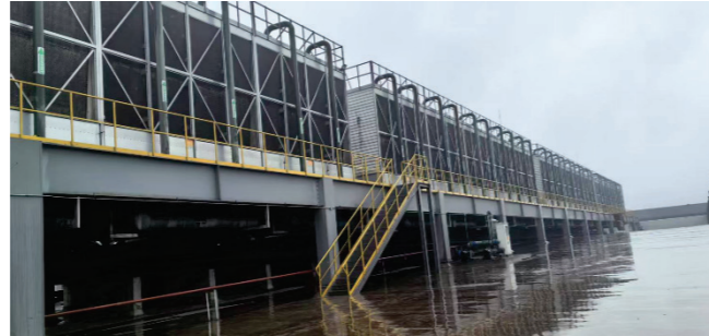
冷凝水收集回用至冷却塔
