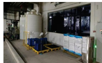
循环水处理现场设备
